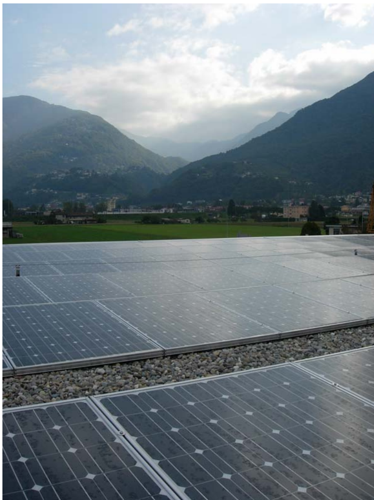
L'impianto di Camorino
