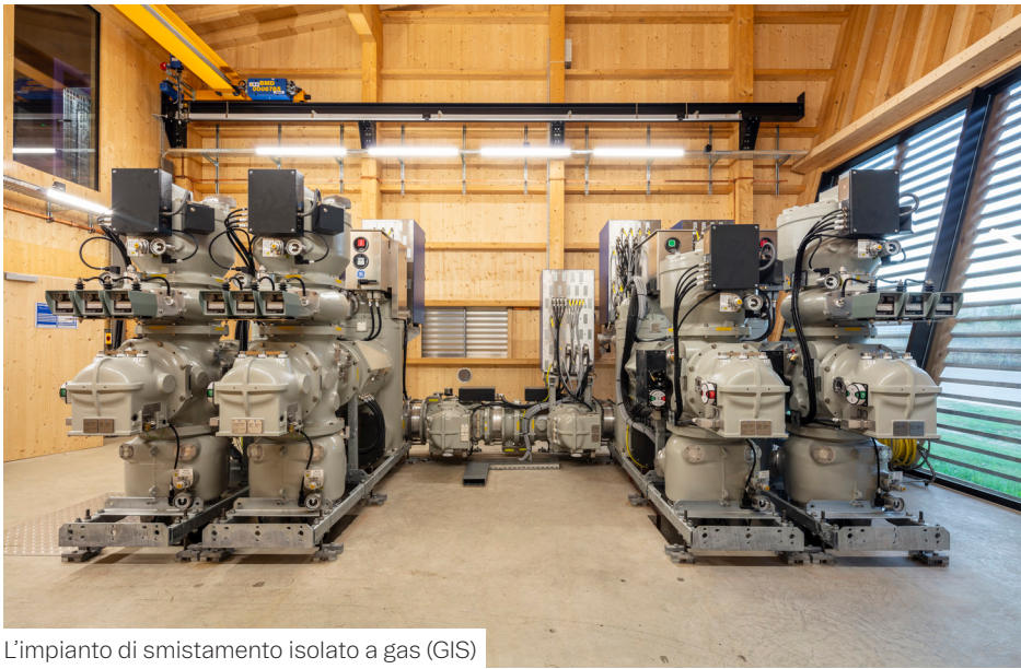
L'impianto di smistamento isolato a gas (GIS)
