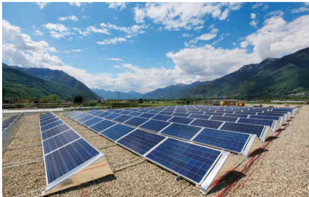
L'impianto fotovoltaico sul tetto di Migros Ticino a Sant'Antonino
